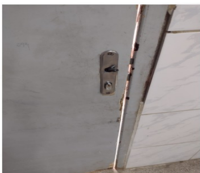
Figura 02 - porta com trinco quebrado
