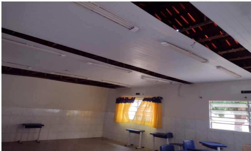
Figura 01 - forro caindo em sala de aula
