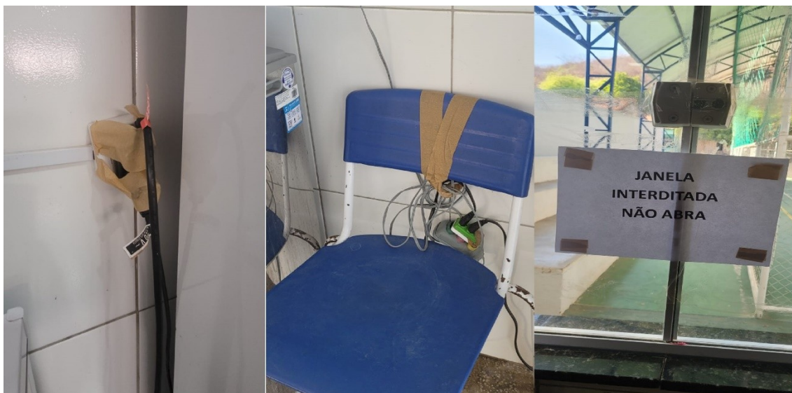
Adaptações Elétricas fora do projeto
