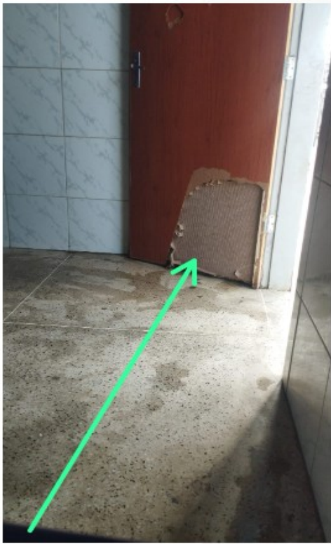
Figura 05 - porta sem trinco
