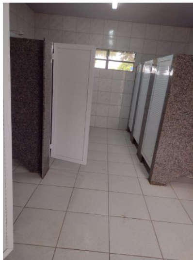
Figura 08 - torneiras sem funcionamento
